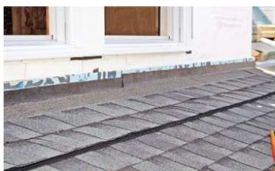
Rufos nas Paredes Verticais
