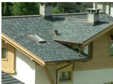
Colarinho Metálico nas Chaminés
